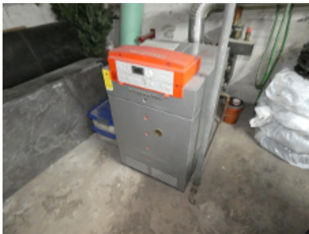
Gas-Heizung im Keller
