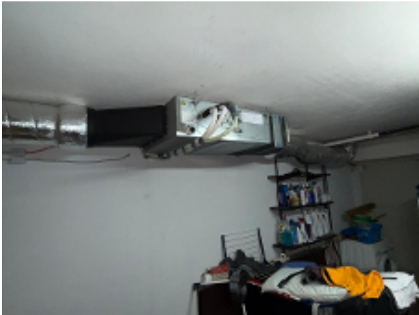
Klimaanlage für EG
