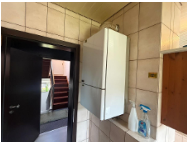
Heizung im OG
