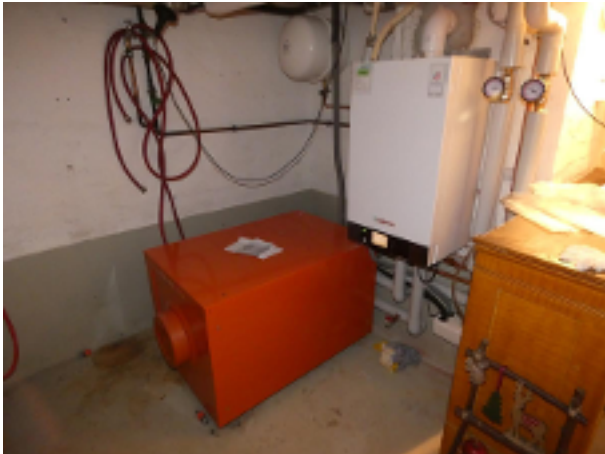
Gasheizung im Keller
