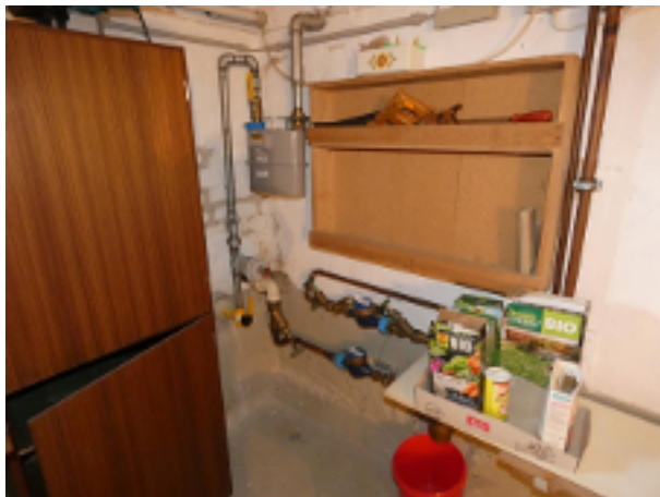
Hausanschlüsse im Keller
