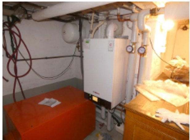
Gasheizung im Keller
