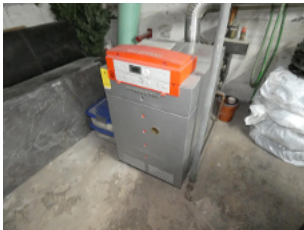
Gas-Heizung im Keller
