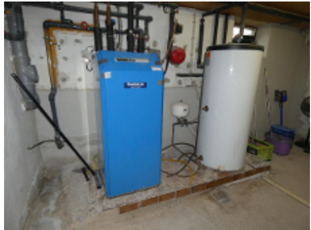
Heizung im Keller
