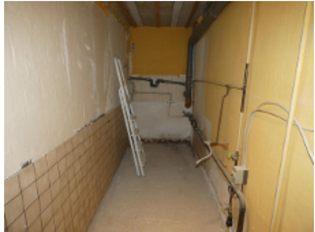
Hausanschlussraum im Keller
