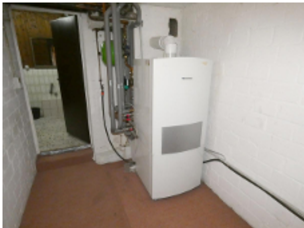
Gasheizung im Keller
