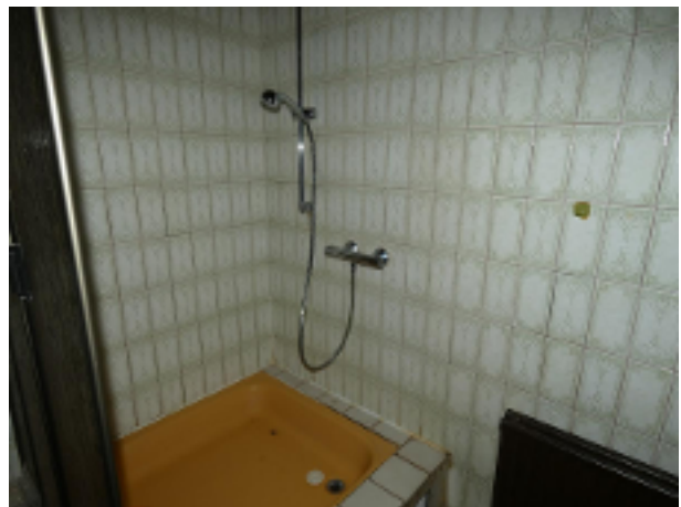
Dusche im Keller
