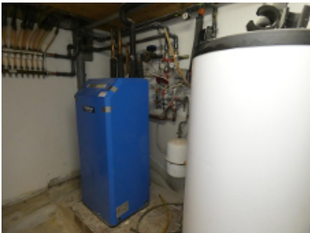
Heizung im Keller
