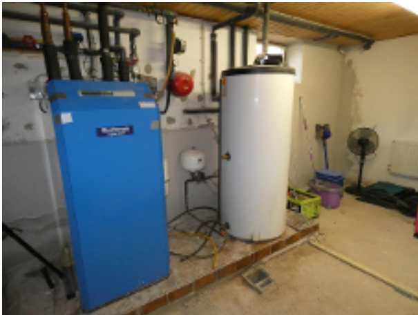
Heizung im Keller
